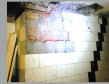
Фото №1: Отслоения, отсутствие керамической плитки
