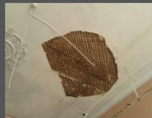
Фото №1: Отслоение штукатурки. Выход из срока эксплуатации
