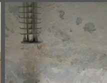
Фото №2: Потёки, трещины
