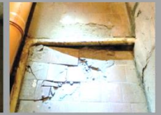
Фото №2: Разбитая плитка
